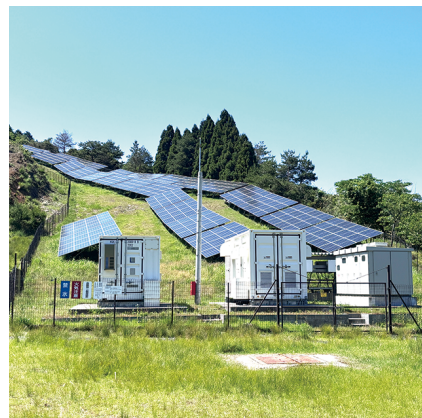
上宮津地区のスキー場跡地に建設されたオムロンのオフサイトPPA。734kWのパネルと大容量蓄電池を併設し、自己託送している
