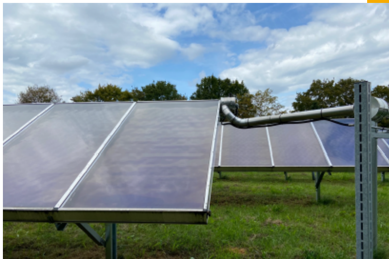
地域熱供給の熱源としての太陽熱利用
